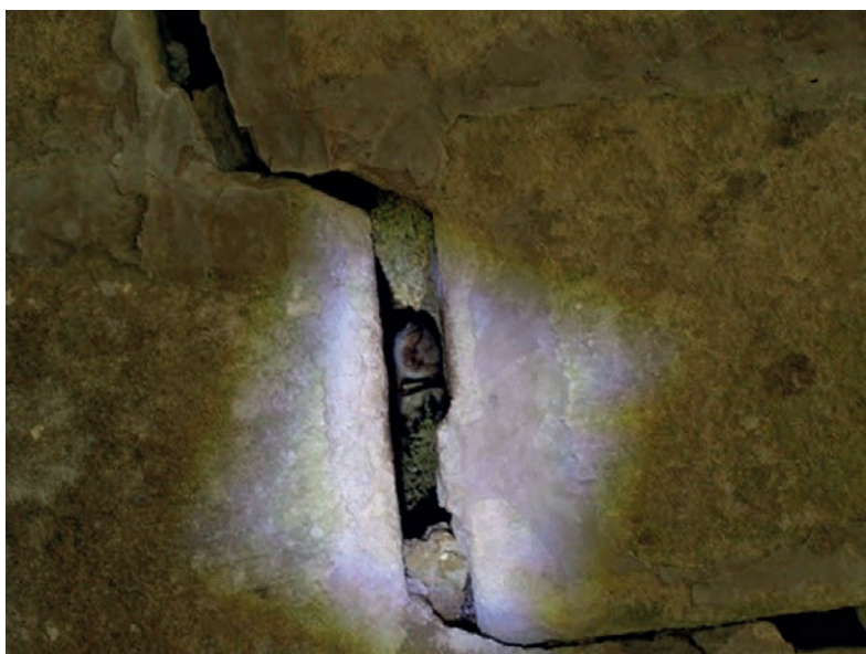
Fracture de voûte maçonnée occupée
